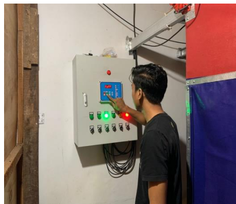
Ket. Pengaturan panel tempron
