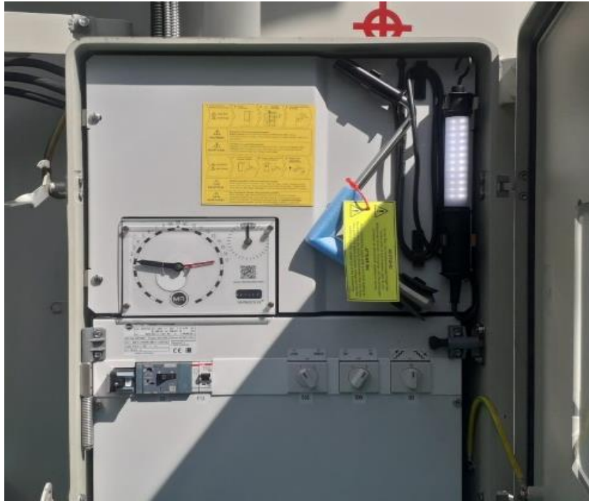
Gambar 15 Motor drive unit pada OLTC di GI Panakkukang
