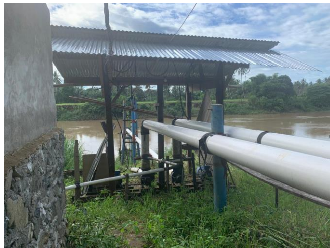
Gambar 2. Pompa Air bertenaga listrik
