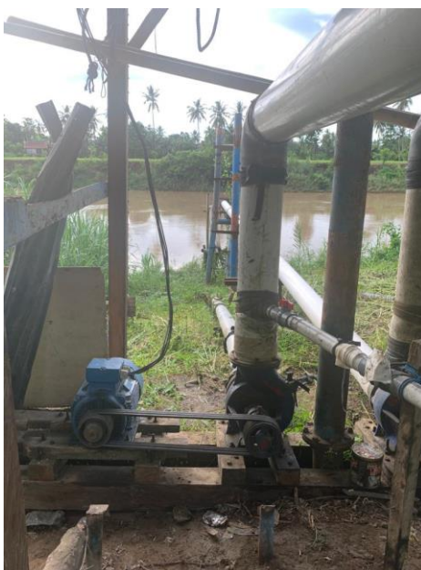
Gambar 3. Pompa Air bertenaga listrik
