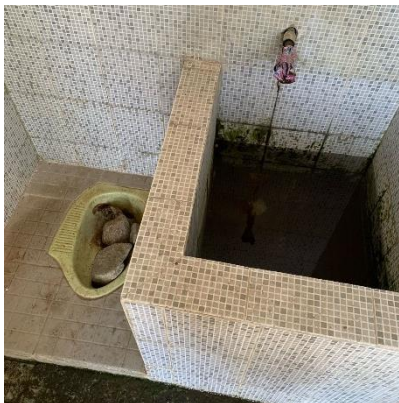
Kondisi MCK Umum di Desa Kalora
