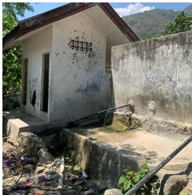
Kondisi MCK Umum di Desa Kalora
