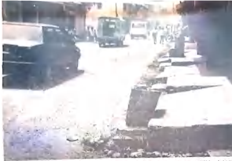
Salah sebuah jalan di kawasan daerah perdagangan di Jl. Sulawesi yang memiliki selokan yang sempit, sehingga daerah tersebut menjadi langganan banjir setiap musim hujan. (Photo : MA).
