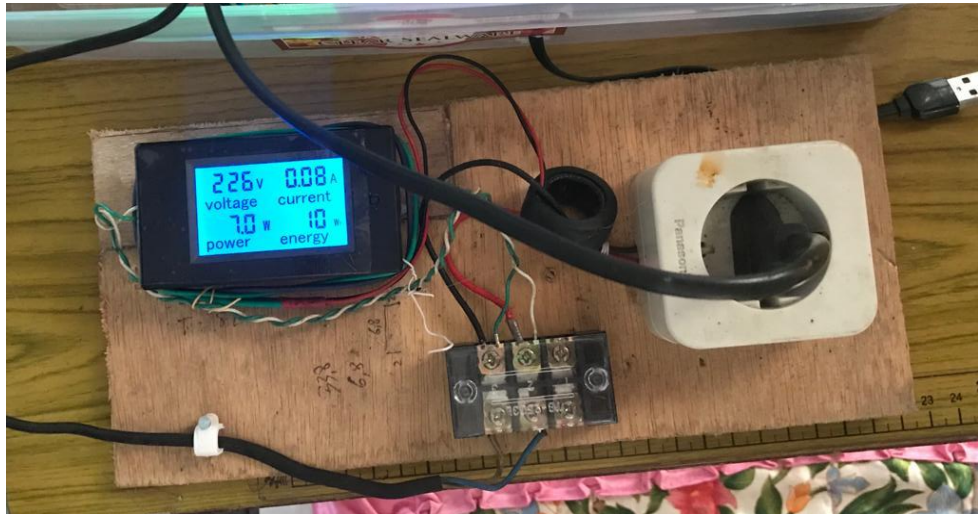
Gambar 3. Rangkaian alat pengontrol energi listrik
