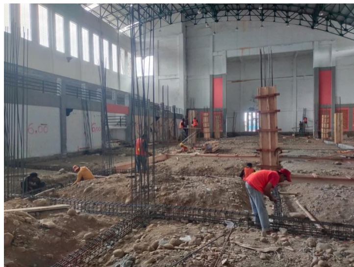
Gambar 1-4 Gambaran kondisi dilapangan masih banyak pekerja yang tidak menggunakan APD dan tidak adanya APK yang digunakan.
