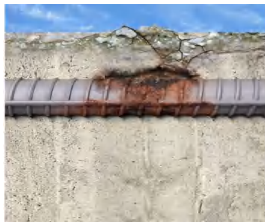
Gambar 8. Korosi pada baja tulangan yang menyebabkan spalling
