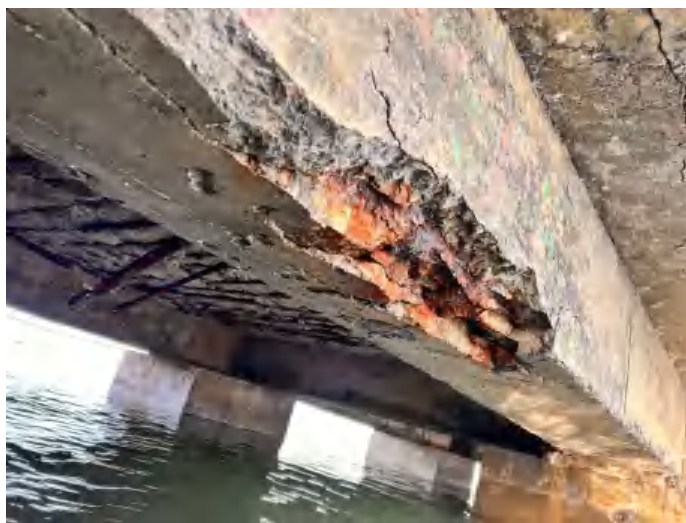
Gambar 1. Korosi pada girder jembatan yang menyebabkan spalling
