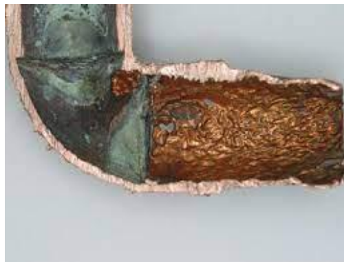
Gambar 7. Korosi Erosi (Utomo, 2009)
