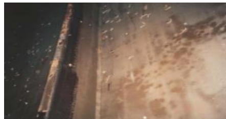
Gambar 11. Korosi mikrobiologi (Utomo, 2009)
