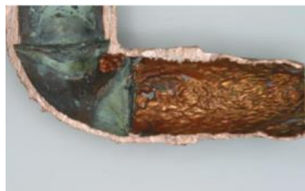
Gambar 7. Korosi erosi (Utomo, 2009)
