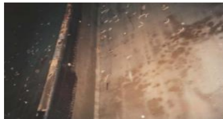
Gambar 11. Korosi mikrobiologi (Utomo, 2009)
