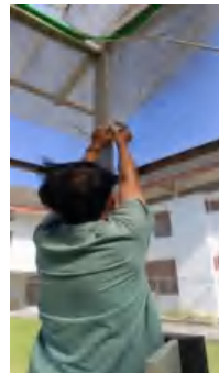
Lampiran 6. Pemasangan sensor DHT22 pada geenhouse
