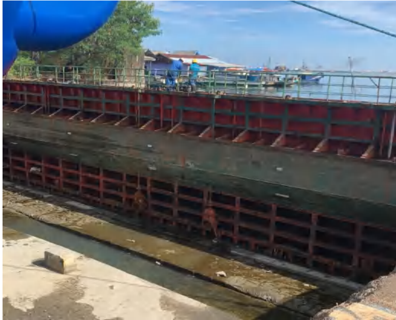
Pengecekan pintu air di graving dock dimana pekerja tidak menggunakan APD safety belt
