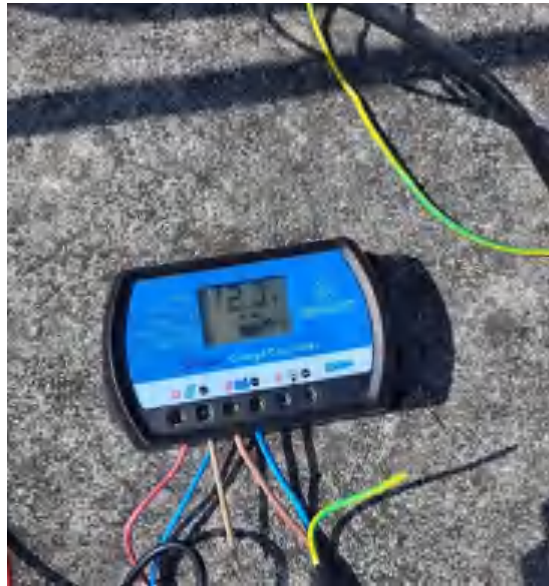
Gambar L.7 Tegangan yang masuk ke charge controller 12,3 V
