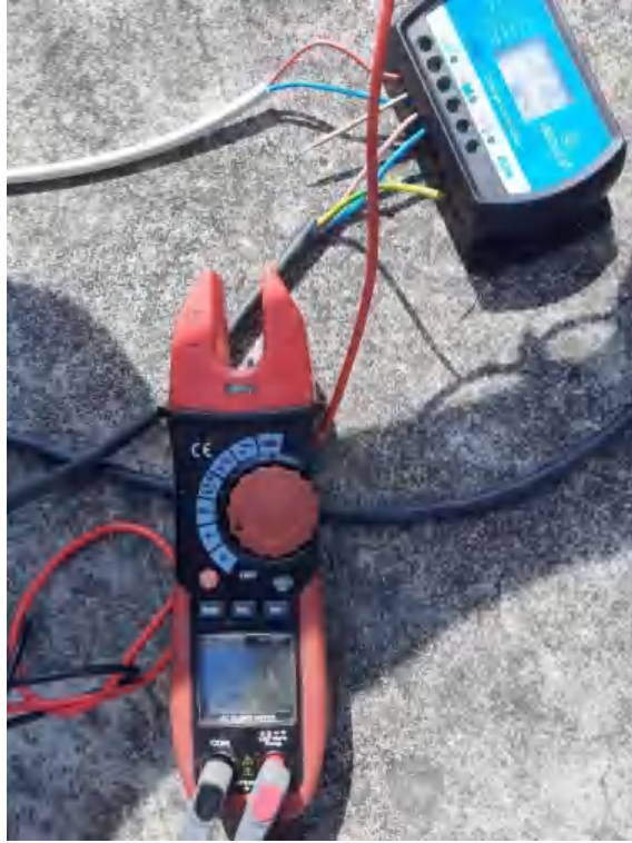
Gambar L.9 Pengukuran tegangan pada baterai sebesar 12,35 V
