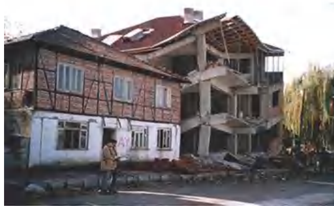
Gambar 1 Kondisi kerusakan yang berbeda pada bangunan kayu tradisional dan beton bertulang pasca gempa Duzce tahun 1999 Sumber : Doğangün A, 2016
