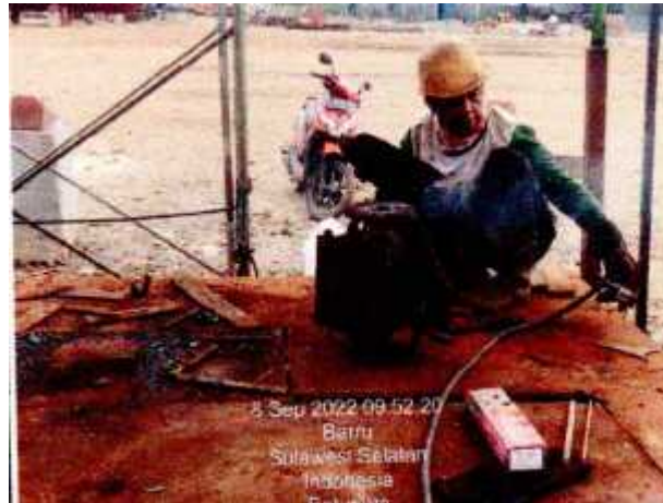
Gambar 20 Penggantian Pipa Striner yang Keropos
