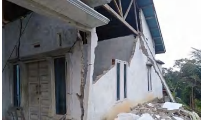
Gambar 1.1 Kerusakan Struktur pada Rumah Tinggal
