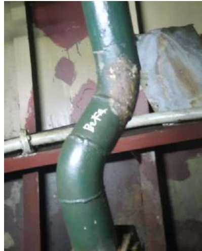
Perawatan Sistem Perpipaan
