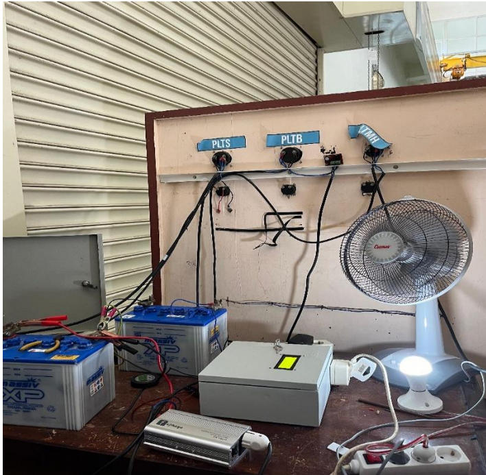
Lampiran 3. Foto pengujian sistem kontrol pada pembangkit
