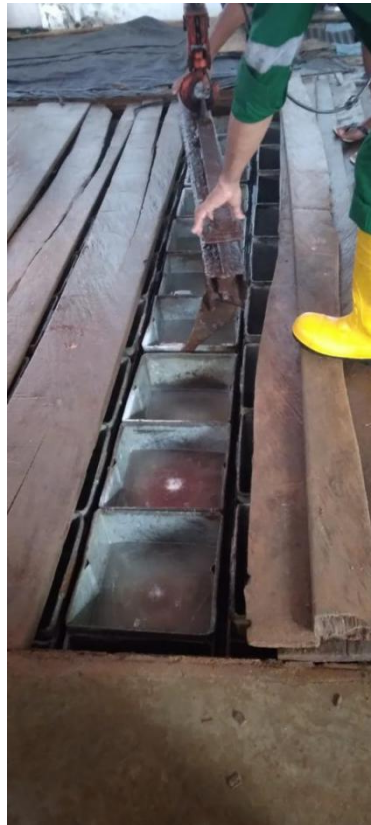
Tampak dalam pabrik es PPN Kwandang
