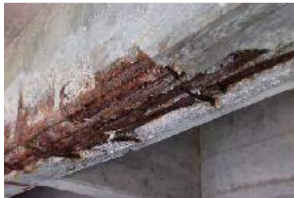
Gambar 1. Spalling pada beton akibat korosi
