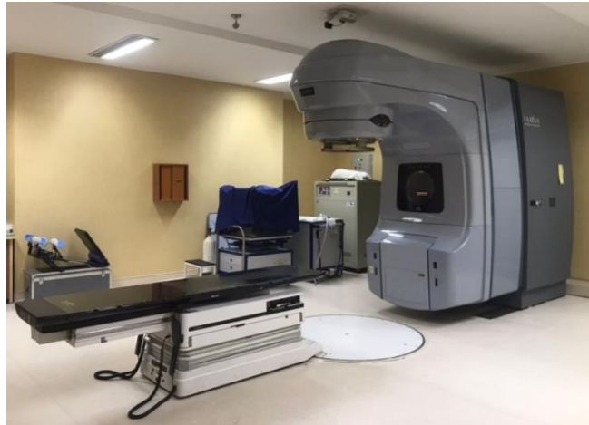
Gambar 2.1 Pesawat Linear Accelerator pada Instalasi Radioterapi RS Universitas Hasanuddin
