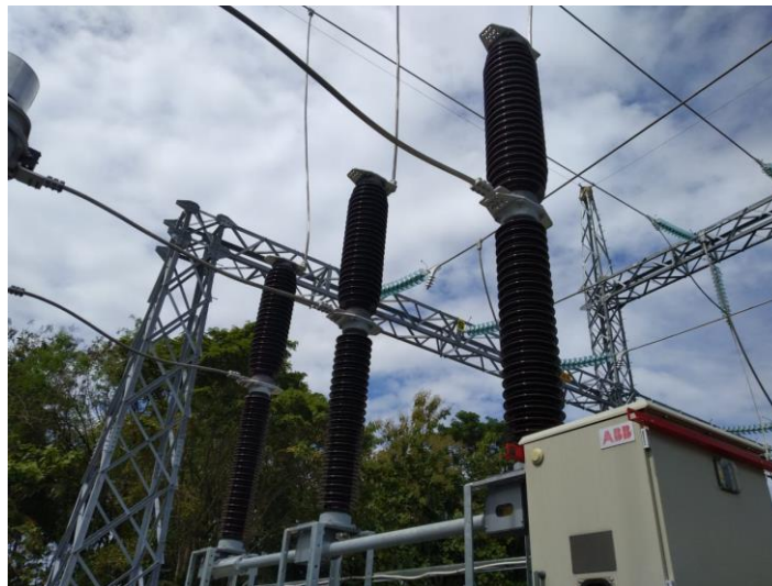
Gambar 2.5 Seperangkat PMT pada switchyard gardu induk Sumber: dokumentasi penulis
