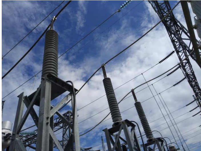
Gambar 2.9 Seperangkat LA pada switchyard gardu induk Sumber: dokumentasi penulis
