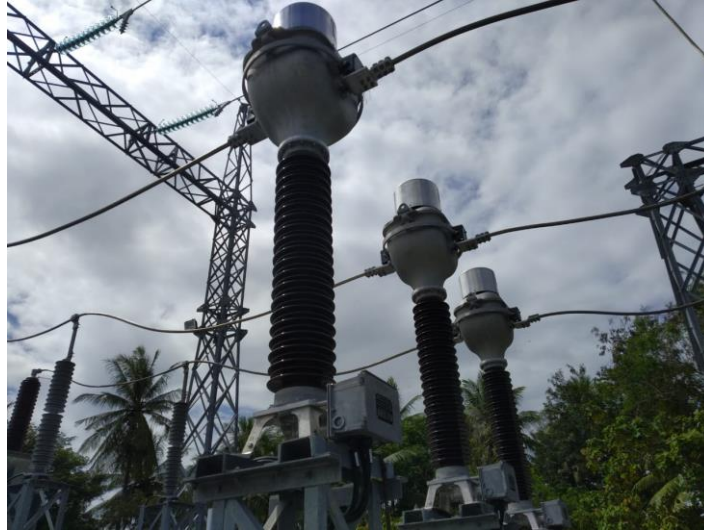
Gambar 2.7 Seperangkat CT pada switchyard gardu induk Sumber: dokumentasi penulis
