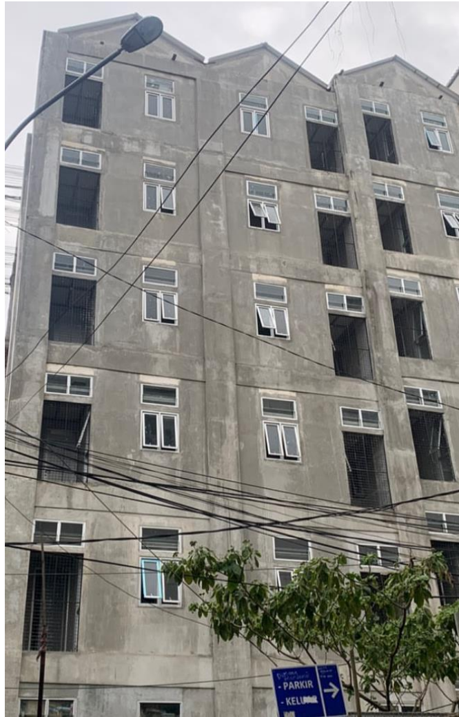
Gambar 10 Kondisi rumah deret unit pertama pada Desember 2022
