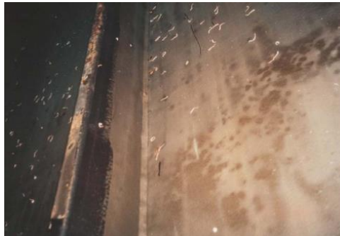
Gambar 7. Korosi mikrobiologi (Utomo, 2009)
