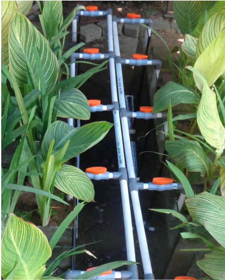
Gambar 12. Instalasi Perpipaan Reaktor
