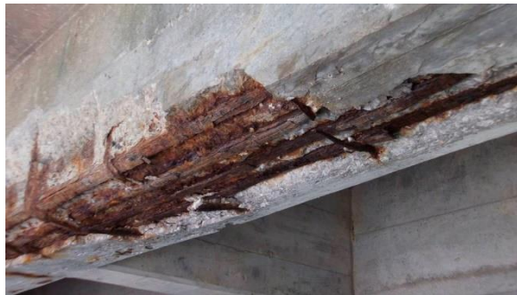
Gambar 1. Kerusakan pada beton akibat korosi tulangan baja.
