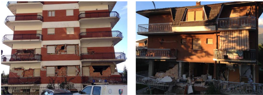
Gambar 6. Kerusakan akibat gempa bangunan gedung yang memiliki pengisi bata pada kerangka beton bertulang (bangunan dengan rekayasa) (Da Porto et al. , 2009)
