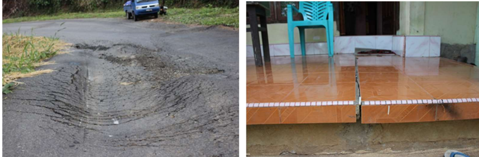
Gambar 1. Kerusakan jalan dan rumah penduduk
