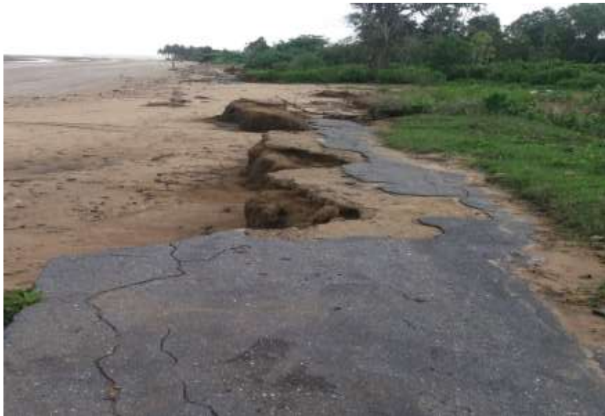
Gambar 11. Putusnya Jalan Darat Penghubung ke Penyeberangan Kumbe (Sumber : Dokumentasi Peneliti, 2019)
