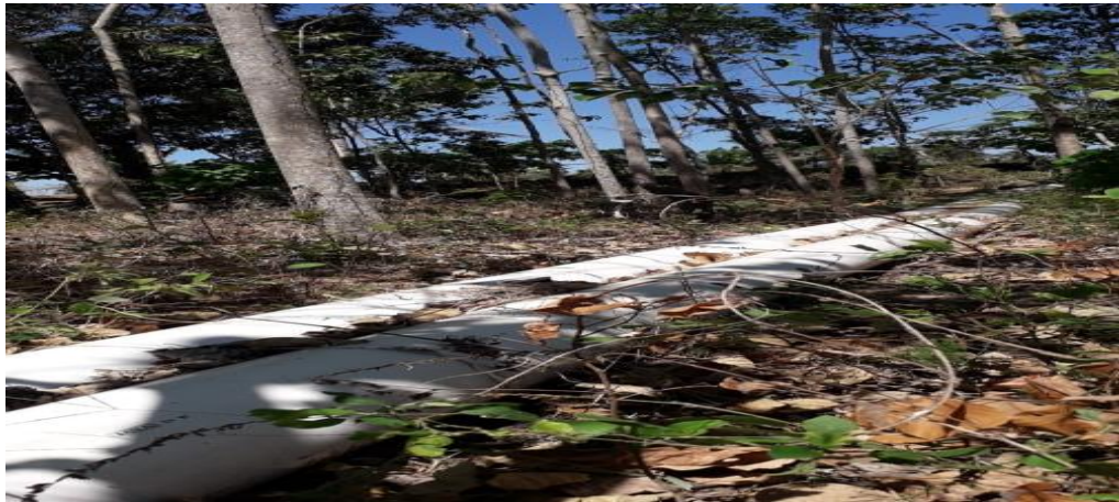
Dokumentasi. Air dari Sungai Diteruskan Menggunakan Pipa Saluran
