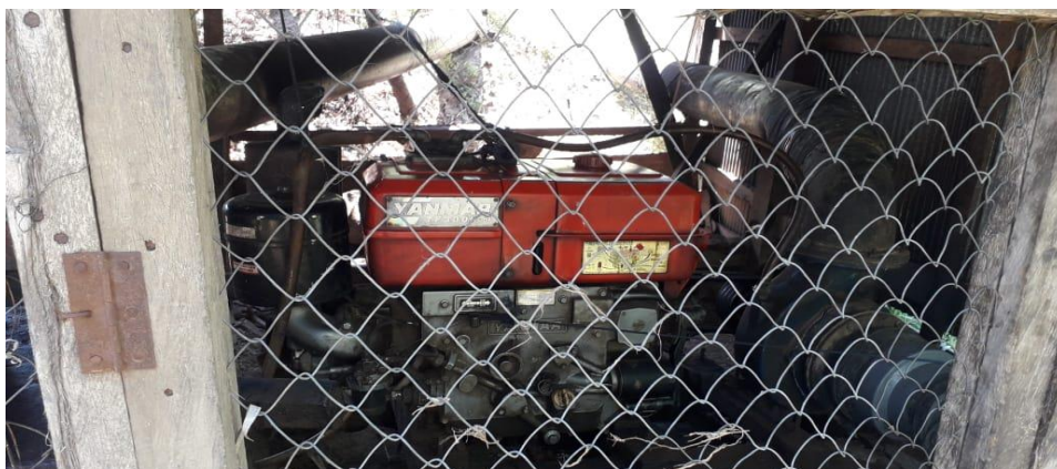
Dokumentasi Mesin Pompa Utama
