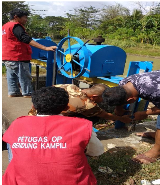
Gambar 7. proses pembukaan pintu air
