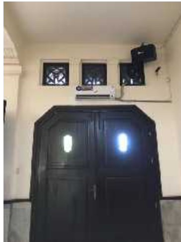
Foto 38. Pendingin ruangan dan pengeras suara di ruangan hall dan ruang pengelola
