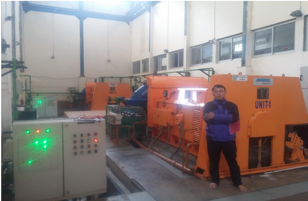
1. Powerhouse PLTM Bungin 1
