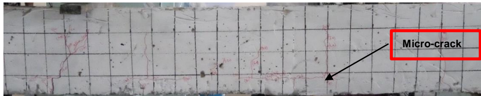
Gambar 52. Micro-crack Pada Sambungan
