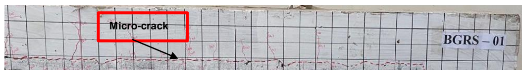
Gambar 58. Micro-Crack Pada Sambungan
