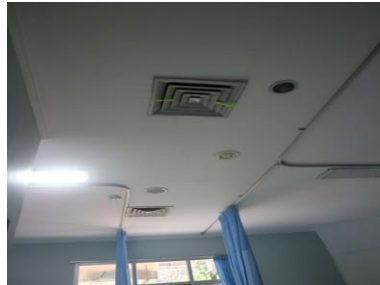
Gambar 2. 5 Instalasi Pengkondisian Udara Serta Exhaust Fan sebagai Pembantu Penetralisir Udara pada Ruang Rawat Isolasi.
