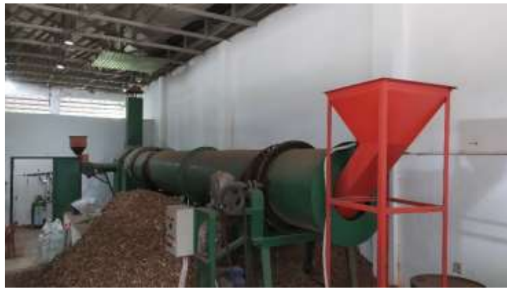
Foto Tempat Pengolahan Sampah Setempat (TPSS) Kota Depok
