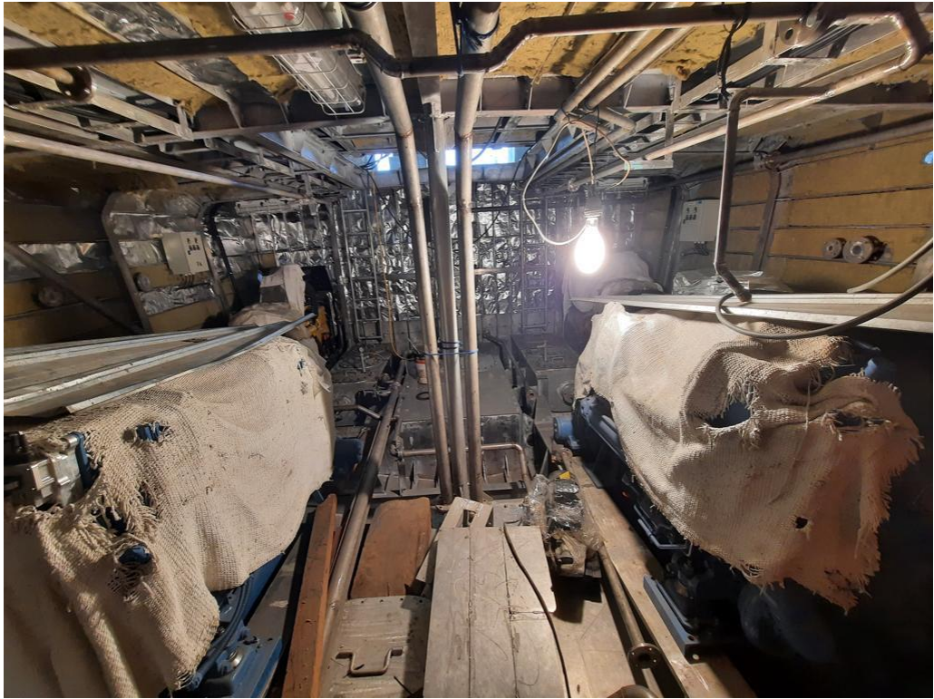
Gambar kamar mesin KN.P. 379
