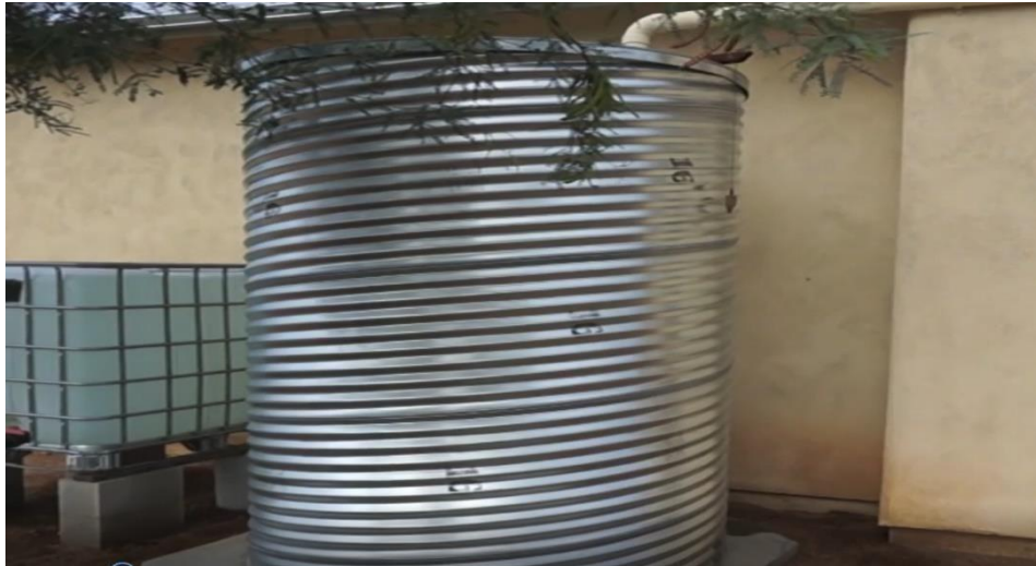
Gambar 2.11 Tangki Penampungan (Kapasitas 1100 galon)
