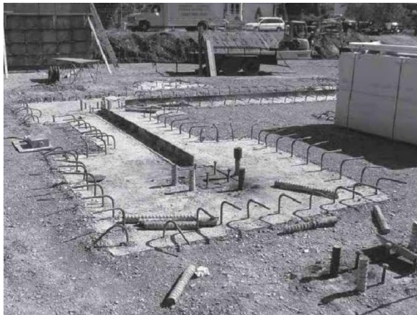
Gambar 13. Detail Pada Dasar SPSW, ING Building (Sumber: Louis Crepeau dan Jean-Benoit Ducharme, Groupe Teknika, Montreal, Kanada)
