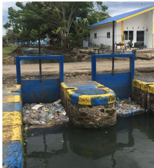
Gambar 14. Pintu air yang tersumbat
