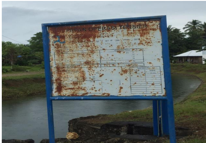
Gambar 7. Kondisi Papan Operasi yang Rusak
