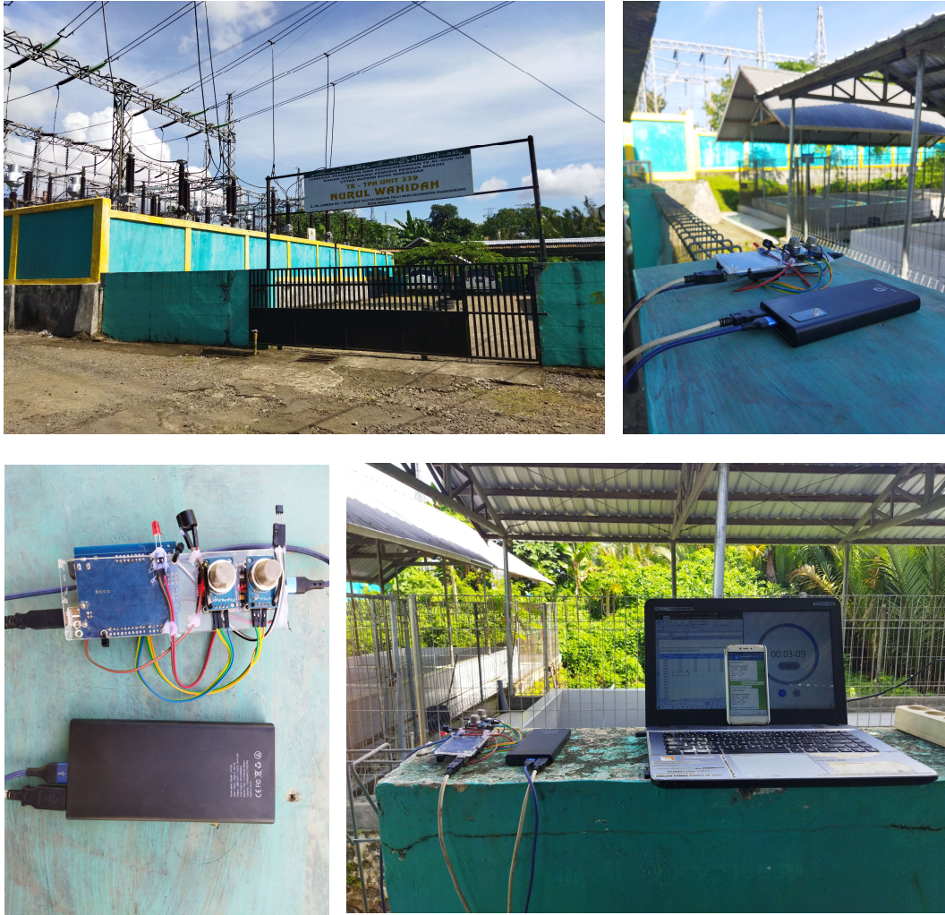
Pengujian sistem monitoring udara di PLTD Tello.
