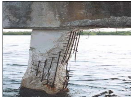
b. Kerusakan beton akibat korosi tulangan memanjang
