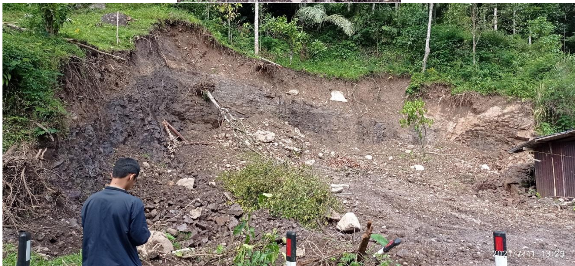
Kejadian tanah longsor di desa Arabika
