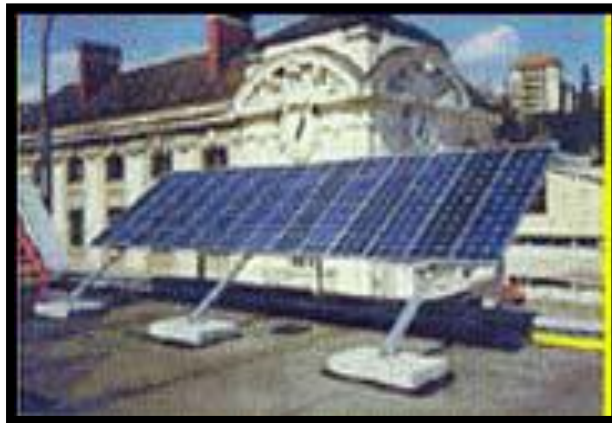
Gambar PV pada Atap dengan penyangga
