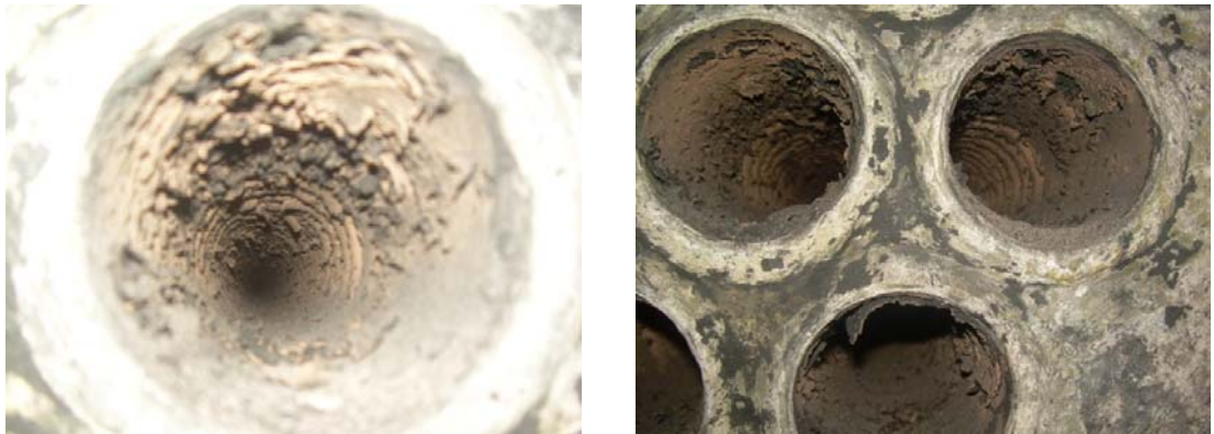
Gambar 6. Fouling di dalam pipa api
